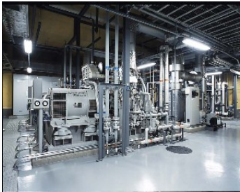
コージェネレーション設備
